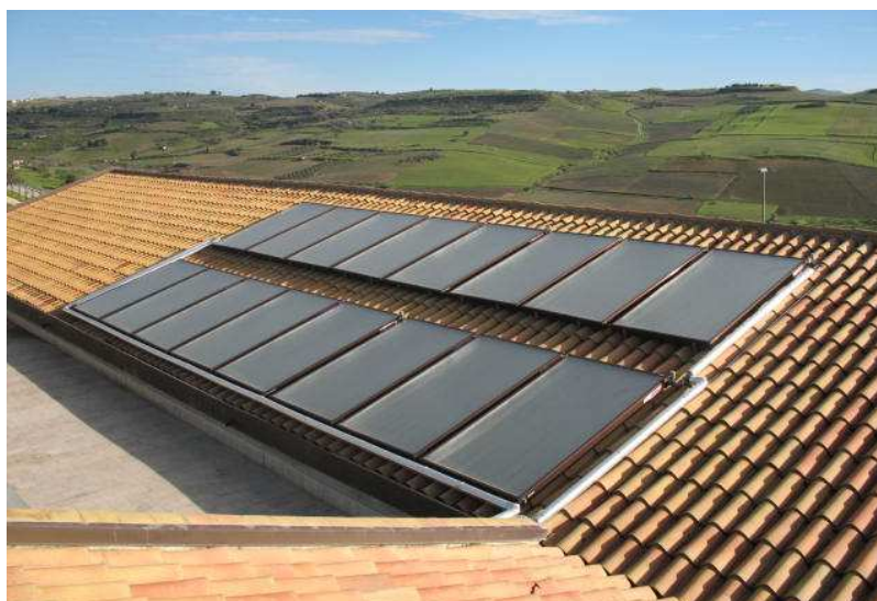
Fotografia dell'impianto a pannelli solari ad agosto 2008 sul tetto del magazzino di Feudo Arancio.
